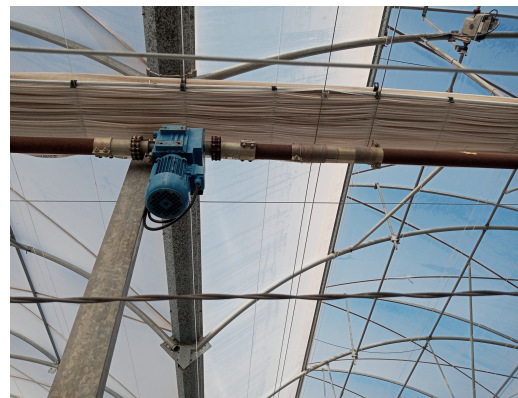
Sistema de cableado accionado
