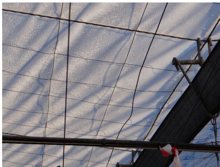
Fotografía 1. Agua condensada en la cara interna del plástico en un invernadero parral en Almería.
